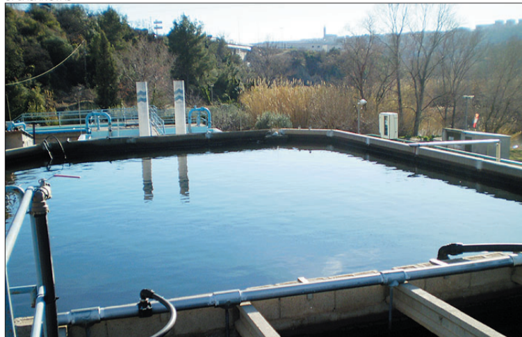
Vistes del decantador de la planta de tractament del Mas de les Aigües
